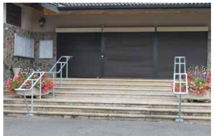
Mains courantes escalier
