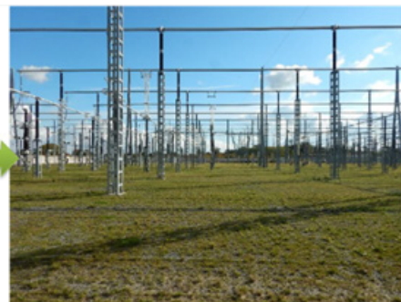
Poste de Oudon après végétalisation
