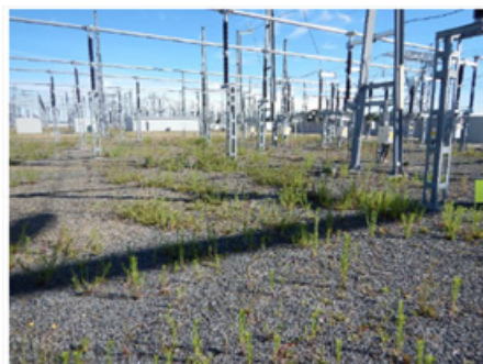
Poste de Oudon avant végétalisation
